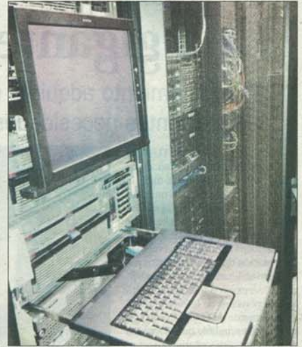
Un equipo en la sala de CPU del Ayuntamiento.
